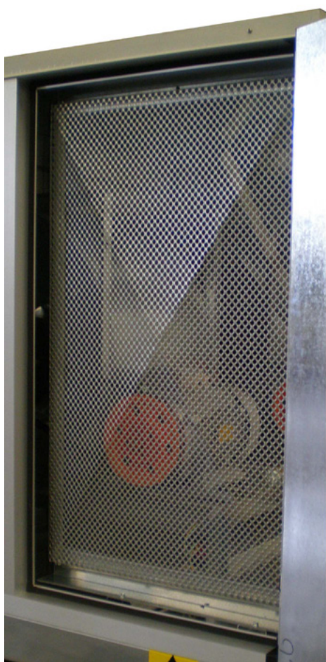
Rete di protezione / Protection grid
